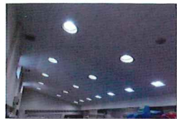
多目的棟LED 照明
